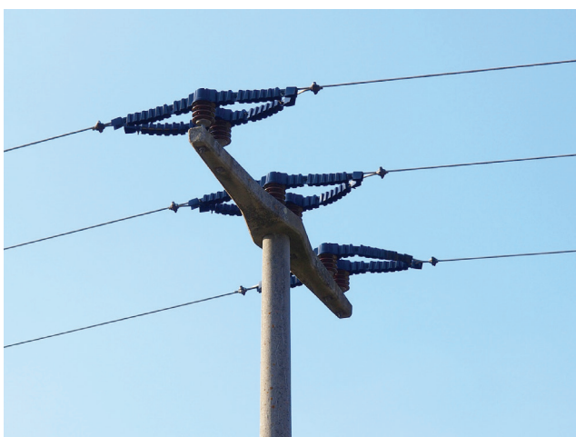
Vogelschutzarmaturen verhindern, dass Vögel gleichzeitig den Mast und eine Leitung berühren.
