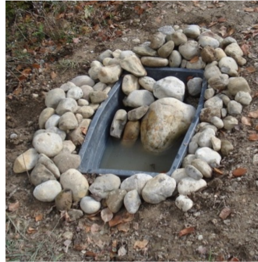
Ill. 14 : Cuve en plastique enterrée avec pierres à Fischingen (TG)
