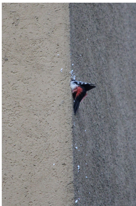
Attraverso i fori dei picchi penetra umidità e si riduce l'effetto isolante della copertura. I fori dovrebbero quindi essere chiusi il prima possibile. Le riparazioni sono tuttavia tabù finché uccelli vi allevano piccoli. Le loro nidiate sono protette dalla legge! © Hugo Rey
