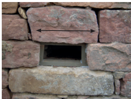
Fig. 7: il „tetto“ (freccia nera) deve essere più lungo della nicchia sui due lati (punto 4 già effettuato in questa foto).
