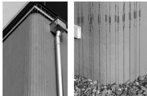
Fig. 3: Fils d'acier sur les parties de la façade menacées par les pics, et détails des éléments tendeurs (photos V. Döbelin).
